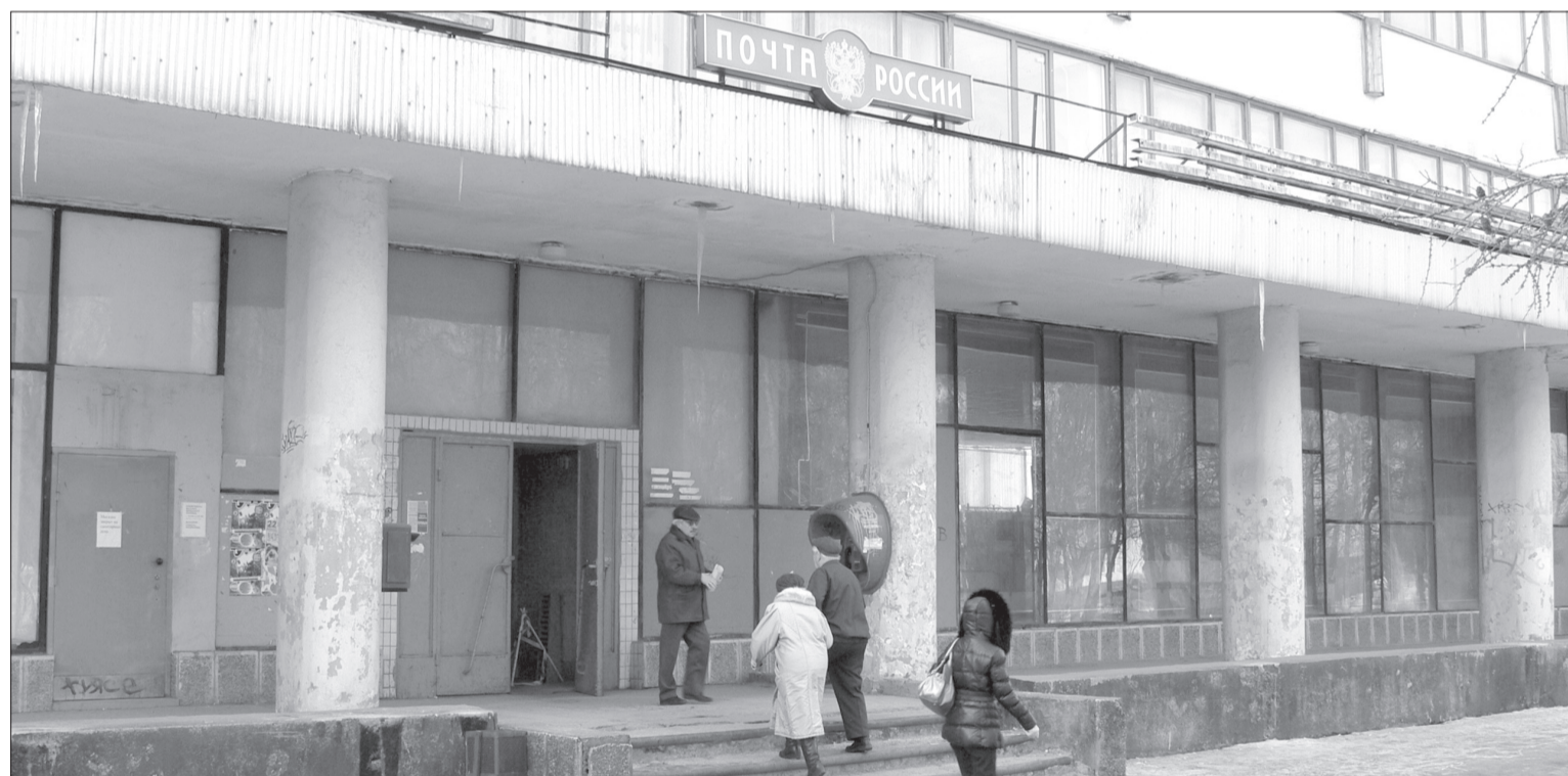
ПОЧТА СЕГОДНЯ. Явно здание давно нуждается в ремонте. А вот новость: сортировку местной корреспонденции вернут в Кириши.
